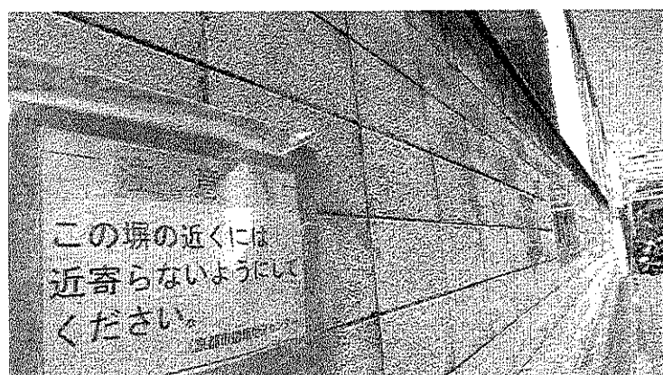
ヘルスピア北側のブロック塀も要点検 ↑
