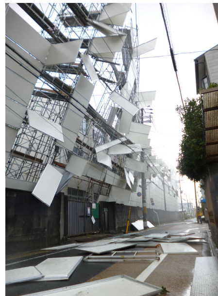
洛陽工業高校の校舎解体工事現場にて(同校北側)カバーのパネルが傾き、一部が落下(9/4午後)。
